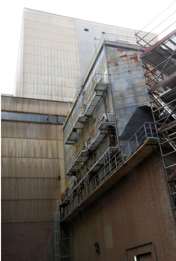
Kraftwerk Niederaußem: Kesselhaus Block E, Ansicht von Norden; Foto: 15.08.2023 Fotograf/Urheber: Dr. Norbert Gilson
