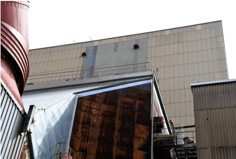
Kraftwerk Niederaußem: Kesselhaus Block D, Ansicht von Nordwesten; Foto: 15.08.2023 Fotograf/Urheber: Dr. Norbert Gilson
