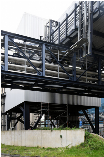
Kraftwerk Niederaußem: Kohleecturm K, Ansicht von Westen; Foto: 17.08.2023 Fotograf/Urheber: Dr. Norbert Gilson
