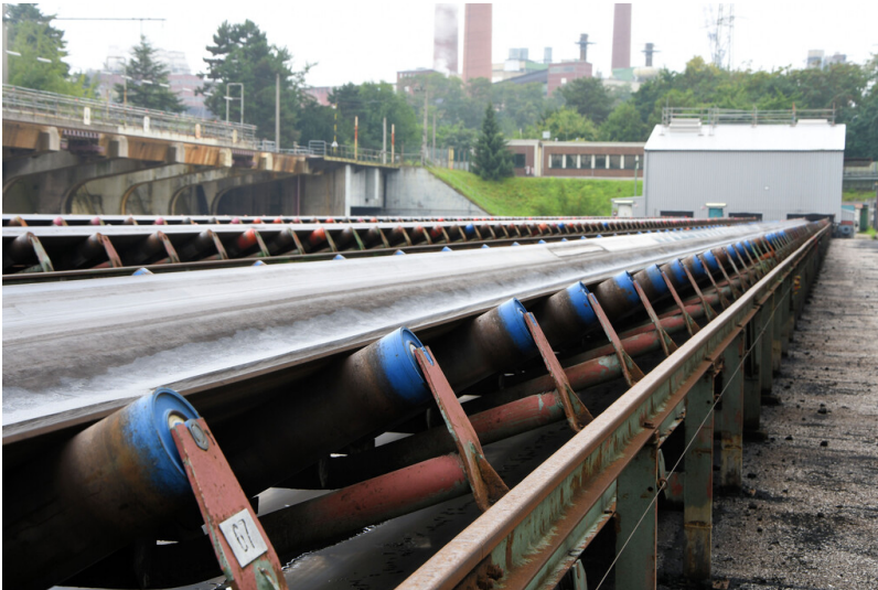
Kraftwerk Niederaußem: Bekohlungsweg zur Verteilerstation 2, Führung der Bunkerbänder zum Kohleleckturm 1, Ansicht von Nordosten; Foto: 17.08.2023 Fotograf/Urheber: Dr. Norbert Gilson
