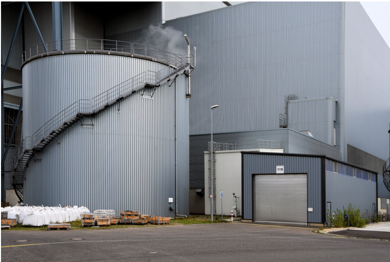
Kraftwerk Neurath: Deionatspeicher F/G, vor der Vollentsalzungsanlage F/G, Ansicht von Westen; Foto: 23.10.2023 Fotograf/Urheber: Dr. Norbert Gilson
