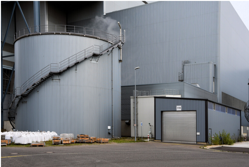
Kraftwerk Neurath: Deionatspeicher F/G, vor der Vollentsalzungsanlage F/G, Ansicht von Westen; Foto: 23.10.2023 Fotograf/Urheber: Dr. Norbert Gilson
