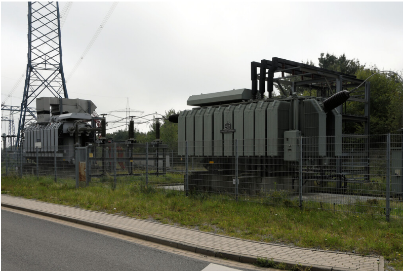
Kraftwerk Neurath: Anfahranlage Blöcke F/G, 110/10,5-kV-Transformatoren, Ansicht von Westen; Foto: 14.09.2023 Fotograf/Urheber: Dr. Norbert Gilson
