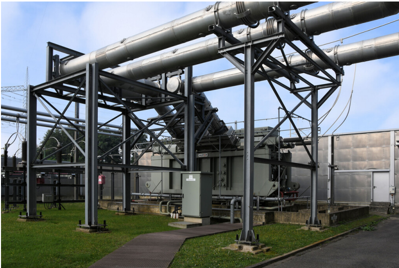
Kraftwerk Neurath: Transformator E16, Ansicht von Osten; Foto: 14.09.2023 Fotograf/Urheber: Dr. Norbert Gilson
