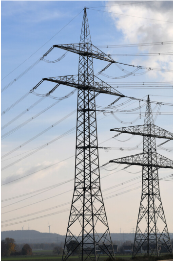
Kraftwerk Neurath: Hochspannungsleitung Blöcke F/G - Umspannanlage Rommerskirchen, Anschluss an Abspannmast 12 (Leitung Bl.-Nr. 4517) (linker Mast), rechts Leitung Bl.-Nr. 4535, Ansicht von Norden; Foto: 22.11.2023 Fotograf/Urheber: Dr. Norbert Gilson
