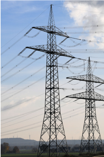
Kraftwerk Neurath: Hochspannungsleitung Blöcke F/G - Umspannanlage Rommerskirchen, Anschluss an Abspannmast 12 (Leitung Bl.-Nr. 4517) (linker Mast), rechts Leitung Bl.-Nr. 4535, Ansicht von Norden; Foto: 22.11.2023 Fotograf/Urheber: Dr. Norbert Gilson
