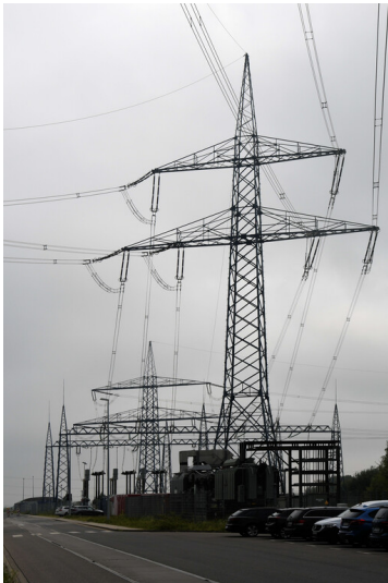
Kraftwerk Neurath: Abspannmast zur Aufnahme der von den Abspannportalen von Block F (rechte Traverse) und von Block G (linke Traverse) kommenden Leitungsseile und Weiterführung in die Schaltanlage F/G, Ansicht von Nordwesten; Foto: 14.09.2023 Fotograf/Urheber: Dr. Norbert Gilson
