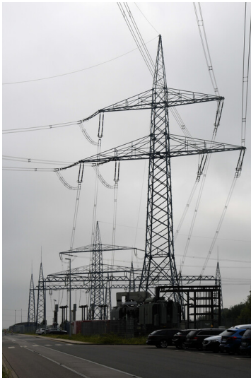
Kraftwerk Neurath: Abspannmast zur Aufnahme der von den Abspannportalen von Block F (rechte Traverse) und von Block G (linke Traverse) kommenden Leitungsseile und Weiterführung in die Schaltanlage F/G, Ansicht von Nordwesten; Foto: 14.09.2023 Fotograf/Urheber: Dr. Norbert Gilson
