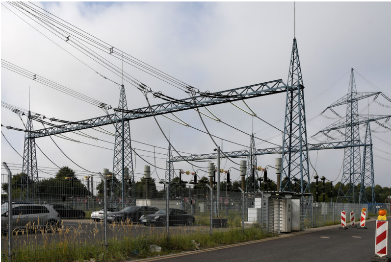
Kraftwerk Neurath: Freiluft-Schaltanlage Blöcke F/G, Abgang der Leitungsseile (Viererbündel) als 380-kV-Leitungen "Neurath 4d" und "Neurath 5e", Ansicht von Nordosten; Foto: 14.09.2023 Fotograf/Urheber: Dr. Norbert Gilson
