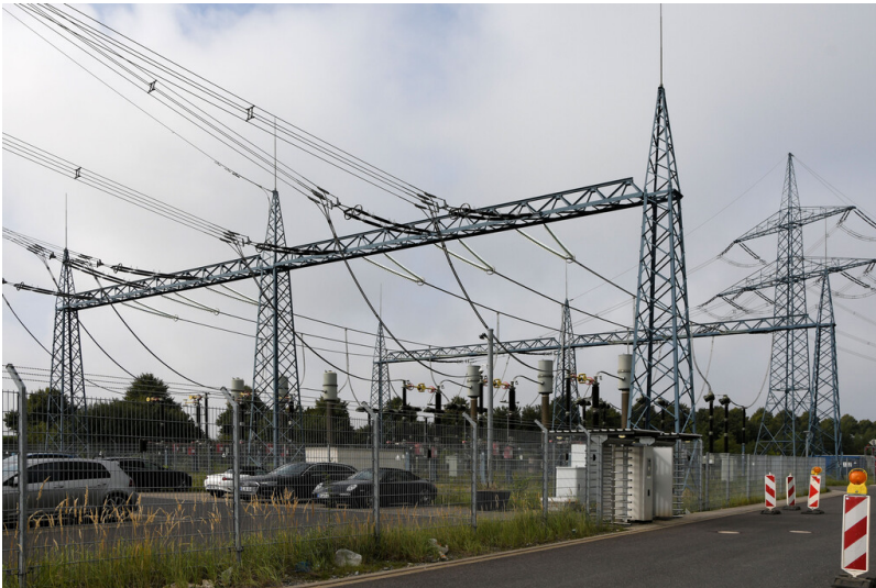
Kraftwerk Neurath: Freiluft-Schaltanlage Blöcke F/G, Abgang der Leitungsseile (Viererbündel) als 380-kV-Leitungen "Neurath 4d" und "Neurath 5e", Ansicht von Nordosten; Foto: 14.09.2023 Fotograf/Urheber: Dr. Norbert Gilson
