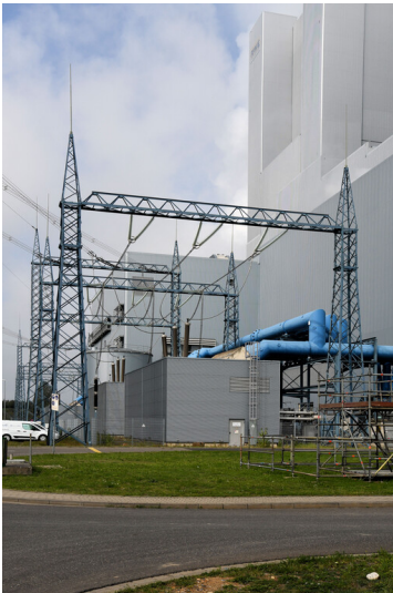
Kraftwerk Neurath: Maschinentransformatoren von Block G, Ansicht von Südosten; Foto: 14.09.2023 Fotograf/Urheber: Dr. Norbert Gilson
