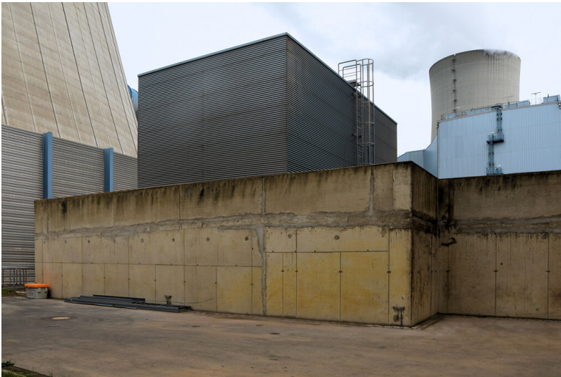
Kraftwerk Neurath (Neuanlage): Kühlwasser-Pumpenhaus Block F, Ansicht von Westen; Foto: 23.10.2023 Fotograf/Urheber: Dr. Norbert Gilson
