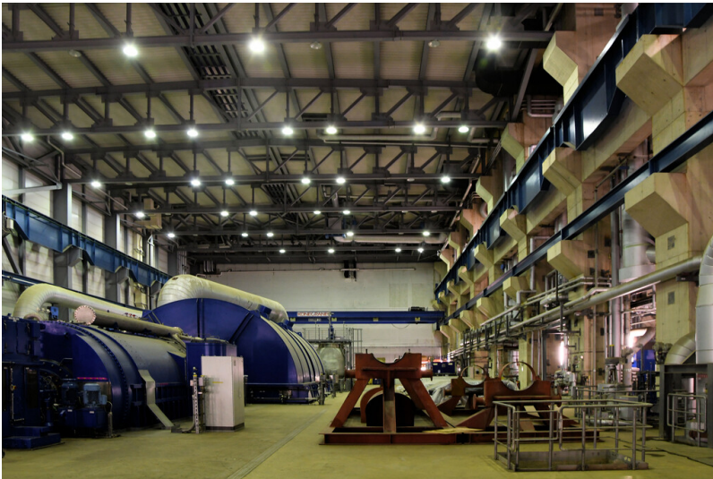
Kraftwerk Neurath: Maschinenhaus Block G, Innenansicht von Osten; Foto: 23.10.2023 Fotograf/Urheber: Dr. Norbert Gilson
