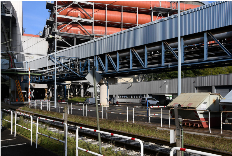
Kraftwerk Neurath: Entschungsweg Ascheverladeturm 1 - Ascheverladung F/G, Ansicht von Südosten; Foto: 12.09.2023 Fotograf/Urheber: Dr. Norbert Gilson
