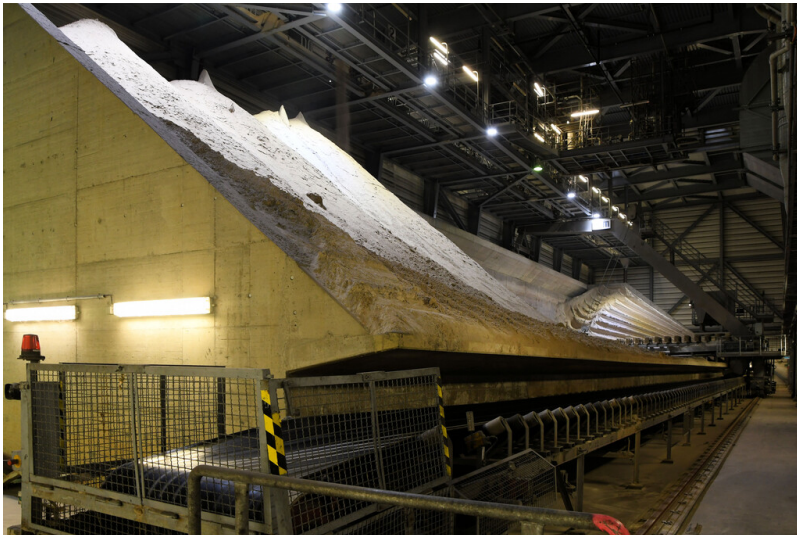
Kraftwerk Neurath (Neuanlage): Gipslager, Bunkertaschen, Gipsabzugsband und Gipsbagger, Innenansicht; Foto: 23.10.2023 Fotograf/Urheber: Dr. Norbert Gilson
