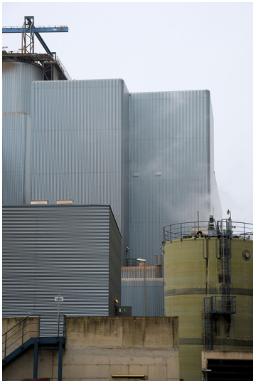
Kraftwerk Neurath (Neuanlage): Gipsentwässerung, Auffangbehälter, Gipsentwässerungsgebäude und Gipslager (im Hintergrund), Ansicht von Osten; Foto: 23.10.2023 Fotograf/Urheber: Dr. Norbert Gilson
