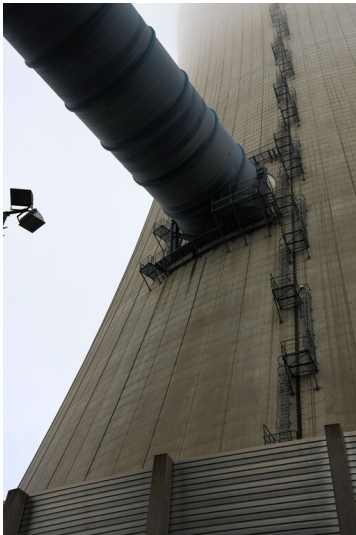
Kraftwerk Neurath (Neuanlage): Reingaseinleitung in den Kühlturm G, Ansicht von Westen; Foto: 23.10.2023 Fotograf/Urheber: Dr. Norbert Gilson
