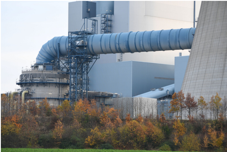
Kraftwerk Neurath (Neuanlage): Reingaseinleitung in den Kühlturm F, Ansicht von Nordwesten; Foto: 22.11.2023 Fotograf/Urheber: Dr. Norbert Gilson
