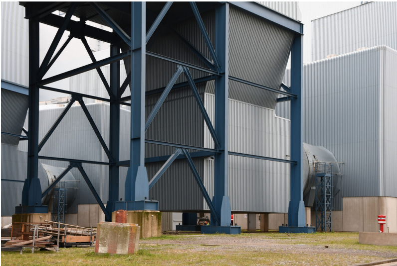
Kraftwerk Neurath (Neuanlage): Rauchgaskanal, Ausgang von Saugzug F1, Ansicht von Nordwesten; Foto: 23.10.2023 Fotograf/Urheber: Dr. Norbert Gilson
