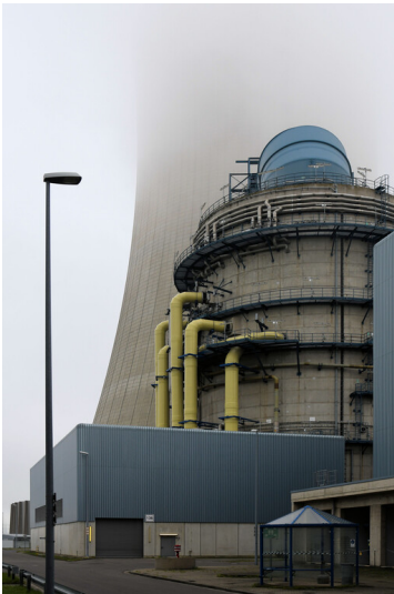
Kraftwerk Neurath (Neuanlage): Absorber Block G, Ansicht von Nordwesten; Foto: 23.10.2023 Fotograf/Urheber: Dr. Norbert Gilson
