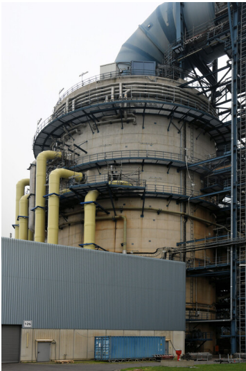
Kraftwerk Neurath (Neuanlage): Absorber Block F, Ansicht von Westen; Foto: 23.10.2023 Fotograf/Urheber: Dr. Norbert Gilson
