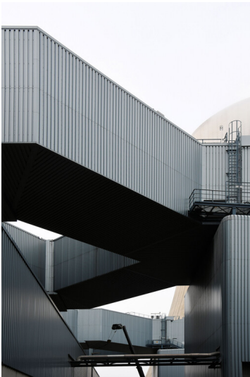
Kraftwerk Neurath (Neuanlage): Elektrofilter Block F, Rauchgaskanäle zu den Saugzügen, Ansicht von Osten; Foto: 23.10.2023 Fotograf/Urheber: Dr. Norbert Gilson
