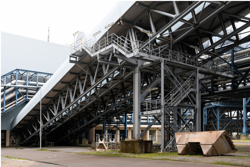
Kraftwerk Neurath (Neuanlage): Bekohlungsbandbrücken vom Brechergebäude zum Zwischenbau Block F, Ansicht von Süden; Foto: 23.10.2023 Fotograf/Urheber: Dr. Norbert Gilson
