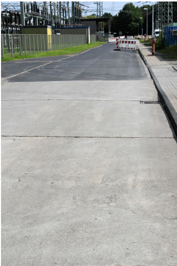
Kraftwerk Neurath: Trafostraße, Ansicht von Westen; Foto: 14.09.2023 Fotograf/Urheber: Dr. Norbert Gilson
