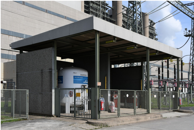
Kraftwerk Neurath: Zentrale Schweißgasstation, Ansicht von Südwesten; Foto: 14.09.2023 Fotograf/Urheber: Dr. Norbert Gilson
