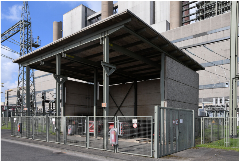
Kraftwerk Neurath: H2-Anlage, Ansicht von Süden; Foto: 14.09.2023 Fotograf/Urheber: Dr. Norbert Gilson
