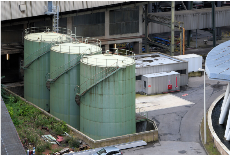
Kraftwerk Neurath: Zündöllager, Lagerbehälter Blöcke A/E, Ansicht von Nordosten; Foto: 12.09.2023 Fotograf/Urheber: Dr. Norbert Gilson
