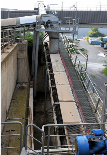
Kraftwerk Neurath: Schmutzwasser-Absetzbecken, Schrägband zum Asche-Fernband, Ansicht von Norden; Foto: 12.09.2023 Fotograf/Urheber: Dr. Norbert Gilson
