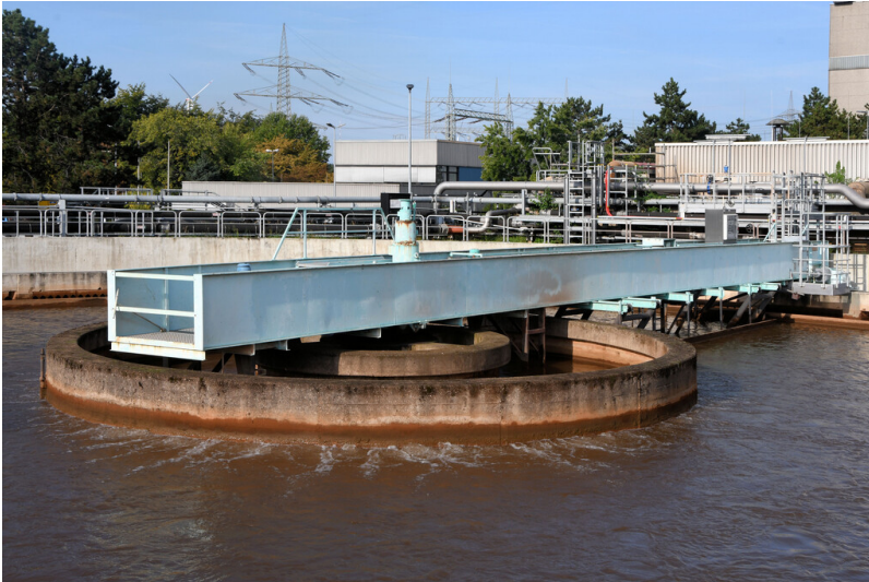
Kraftwerk Neurath: Absetzbecken 1, Rundschlammräumer, Ansicht von Südosten; Foto: 12.09.2023 Fotograf/Urheber: Dr. Norbert Gilson
