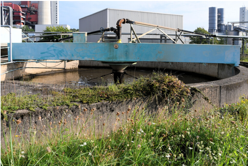
Kraftwerk Neurath: Sandfang 1, Aufhängung des Krählerwerks, Ansicht von Südwesten; Foto: 12.09.2023 Fotograf/Urheber: Dr. Norbert Gilson
