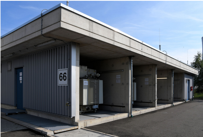
Kraftwerk Neurath: 10-kV-Hauptverteilung, Ansicht von Südwesten; Foto: 12.09.2023 Fotograf/Urheber: Dr. Norbert Gilson
