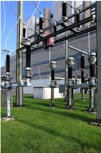
Kraftwerk Neurath: 110-kV-Allgemeinanlage 1, Schaltfeld (Trennschalter, Wandler, Leistungsschalter) für die Einführung der 110-kV-Freileitung "Krahwinkel-Süd", Ansicht von Südosten; Foto: 14.09.2023 Fotograf/Urheber: Dr. Norbert Gilson
