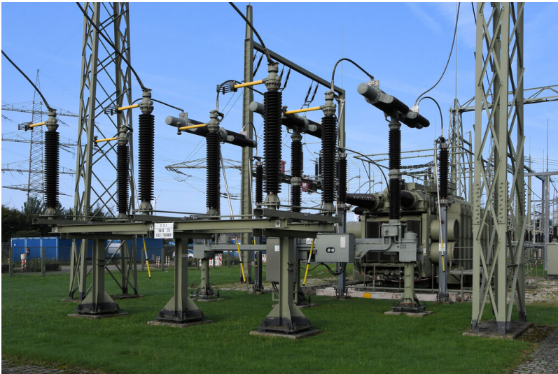
Kraftwerk Neurath: 220-kV-Schaltfeld von Transformator 23, Trenn- und Leistungsschalter, Ansicht von Osten; Foto: 14.09.2023 Fotograf/Urheber: Dr. Norbert Gilson
