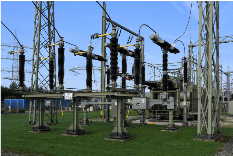
Kraftwerk Neurath: 220-kV-Schaltfeld von Transformator 23, Trenn- und Leistungsschalter, Ansicht von Osten; Foto: 14.09.2023 Fotograf/Urheber: Dr. Norbert Gilson
