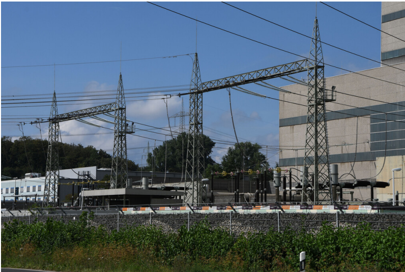
Kraftwerk Neurath: Abspannmast an der Freiluftanlage von Block E (links) mit Führung der Leitungsseile der 380-kV-Hochspannungsleitung "Neurath 3c", Ansicht von Südosten; Foto: 12.09.2023 Fotograf/Urheber: Dr. Norbert Gilson
