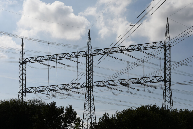
Kraftwerk Neurath: Freileitungsabgang Block E, Führung der Leitungsseile (Viererbündel) auf Abspannportal M 2 (rechte Seite), Ansicht von Osten; Foto: 12.09.2023 Fotograf/Urheber: Dr. Norbert Gilson
