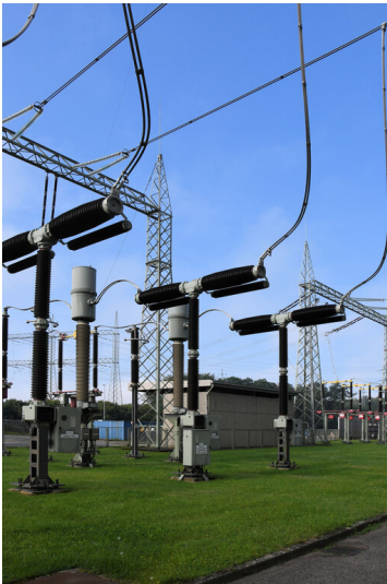
Kraftwerk Neurath: Freileitungsabgang Block D, Schaltfeld, Leistungsschalter, Ansicht von Osten; Foto: 14.09.2023 Fotograf/Urheber: Dr. Norbert Gilson
