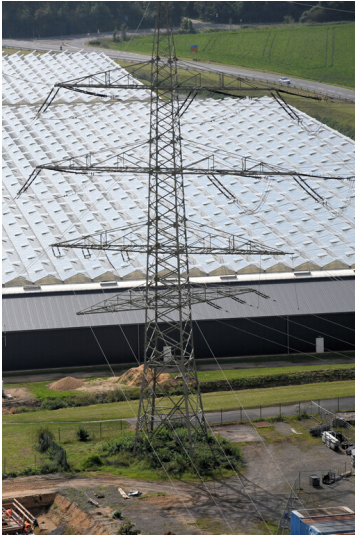
Kraftwerk Neurath: Freileitungsabgang Blöcke B/C, Führung der Leiterseile zum Leitungsabgang "Neurath 2b" auf Abspannmast M 1, Ansicht von Nordosten (Dach von Kesselhaus A); Foto: 14.09.2023 Fotograf/Urheber: Dr. Norbert Gilson
