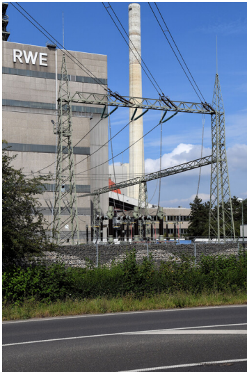
Kraftwerk Neurath: Freiluft-Schaltanlage Block A, Abspannportal und abgehende Leitungsseile, Ansicht von Nordwesten; Foto: 12.09.2023 Fotograf/Urheber: Dr. Norbert Gilson
