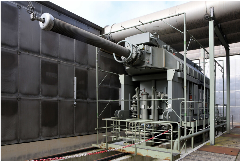
Kraftwerk Neurath: einphasiger Maschinentransformatorpol (21/420 kV, 267 MVA), Phase U (Baujahr 1971) von Block E, Ansicht von Osten; Foto: 14.09.2023 Fotograf/Urheber: Dr. Norbert Gilson
