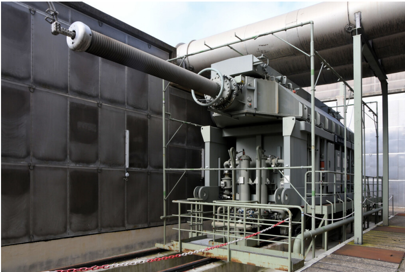
Kraftwerk Neurath: einphasiger Maschinentransformatorpol (21/420 kV, 267 MVA), Phase U (Baujahr 1971) von Block E, Ansicht von Osten; Foto: 14.09.2023 Fotograf/Urheber: Dr. Norbert Gilson
