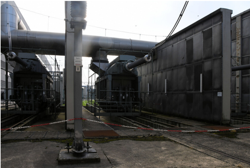
Kraftwerk Neurath: Maschinentransformatorpol (21/420 kV, 267 MVA), Phase V (Mitte) und U von Block D, Ansicht von Westen; Foto: 14.09.2023 Fotograf/Urheber: Dr. Norbert Gilson
