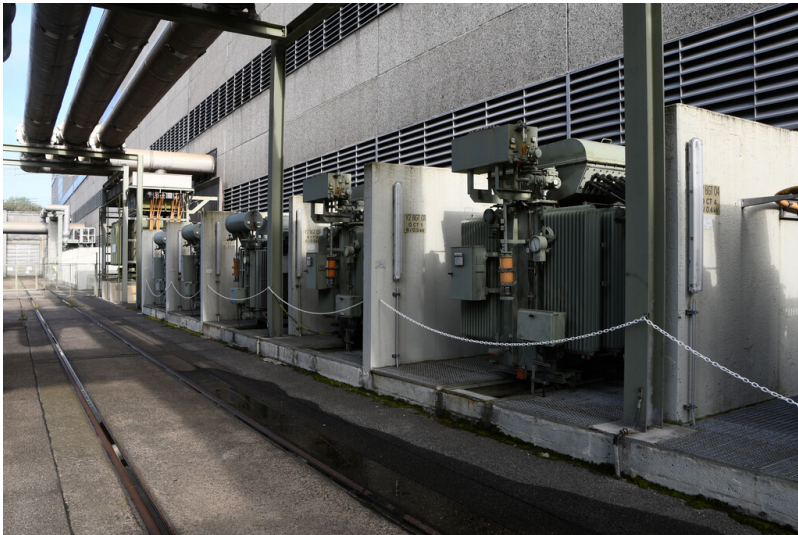
Kraftwerk Neurath: Hastransformatoren Block C, Ansicht von Südosten; Foto: 14.09.2023 Fotograf/Urheber: Dr. Norbert Gilson
