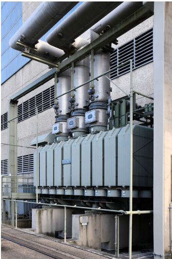
Kraftwerk Neurath: REA-Transformator Block A (21/10 kV, 45 MVA; Baujahr um 1986), Ansicht von Südosten; Foto: 14.09.2023 Fotograf/Urheber: Dr. Norbert Gilson
