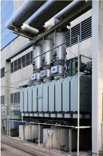
Kraftwerk Neurath: REA-Transformator Block A (21/10 kV, 45 MVA; Baujahr um 1986), Ansicht von Südosten; Foto: 14.09.2023 Fotograf/Urheber: Dr. Norbert Gilson
