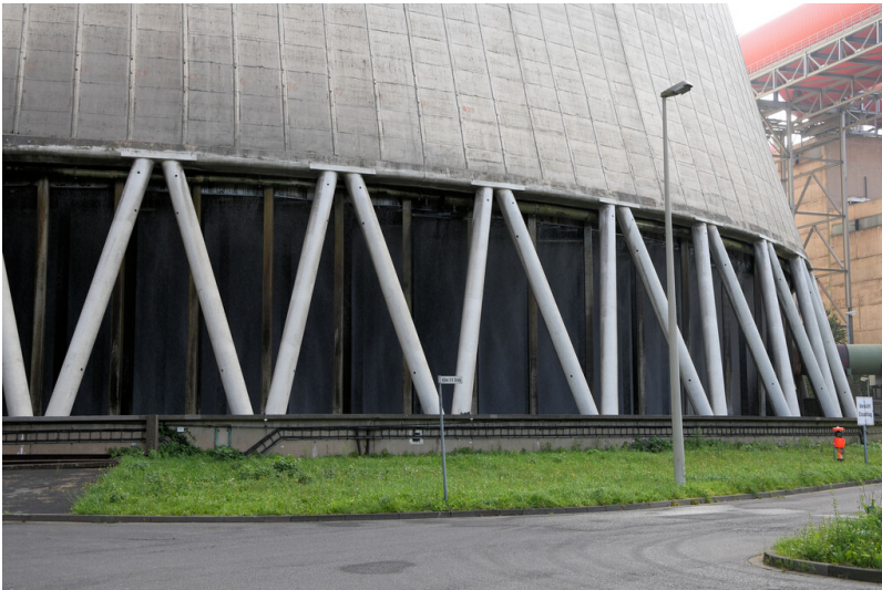
Kraftwerk Neurath: Kühlturm Block E, Kühlturmtasse und Schrägstreben, Ansicht von Osten; Foto: 12.09.2023 Fotograf/Urheber: Dr. Norbert Gilson
