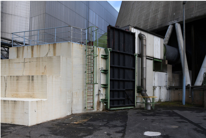
Kraftwerk Neurath: Kühlturm Block D, Kühlwassereinlauf und -auslauf, Ansicht von Südosten; Foto: 12.09.2023 Fotograf/Urheber: Dr. Norbert Gilson
