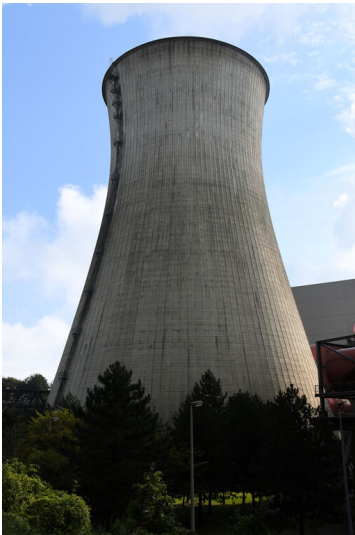
Kraftwerk Neurath: Kühlturm Block B, Ansicht von Nordwesten; Foto: 12.09.2023 Fotograf/Urheber: Dr. Norbert Gilson
