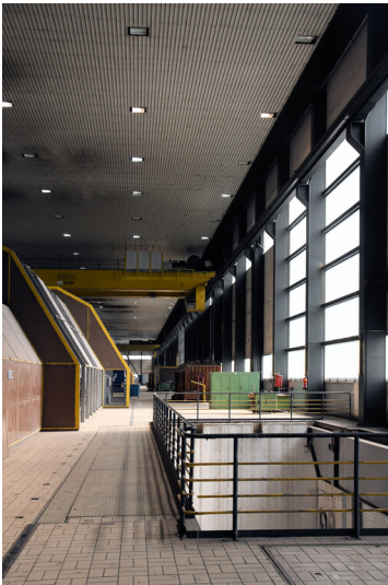
Kraftwerk Neurath: Maschinenhaus D/E, Innenansicht von Westen aus Höhe Block D; Foto: 14.09.2023 Fotograf/Urheber: Dr. Norbert Gilson
