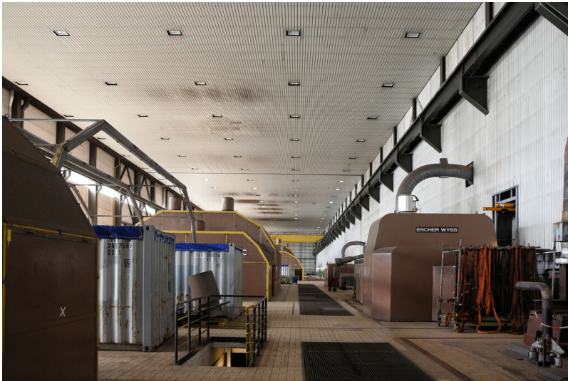
Kraftwerk Neurath: Maschinenhaus A/B, Innenansicht von Osten aus Höhe Block B; Foto: 14.09.2023 Fotograf/Urheber: Dr. Norbert Gilson
