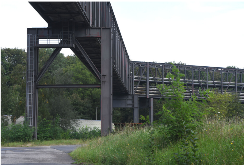
Kraftwerk Neurath: Rohrbrücke zur Führung der Gipsförderleitungen vor dem Gipsentwässerungsgebäude, Ansicht von Süden; Foto: 12.09.2023 Fotograf/Urheber: Dr. Norbert Gilson
